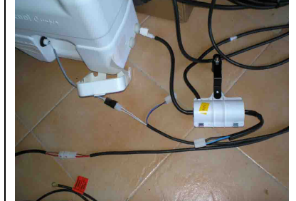
Detalle de las conexiones eléctricas de la bomba y del depósito
