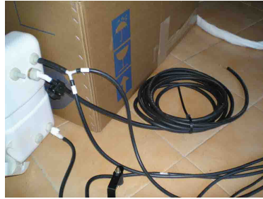
Detalle de las conexiones de agua. El rollo de tubo es la entrada de agua desde la AC
