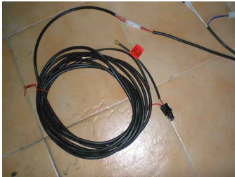
Detalle del cable de conexión a batería, con fusible incorporado
