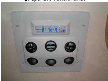
El aparato funcionando
