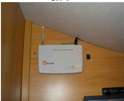
Detalle de la centralita montada. A su derecha, el interruptor para anular los Led's
